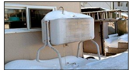
オイルタンク
